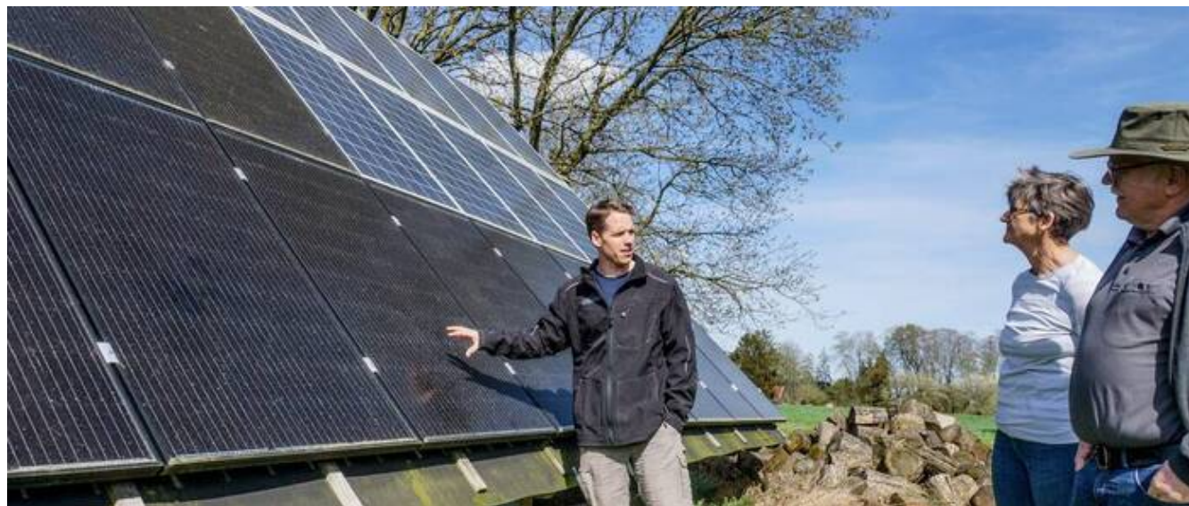
Tim Kleinschmidt erklärt den Besuchern Dörte und Kurt Schröder auf seinem Firmengelände in Homfeld seine frei stehende PV-Anlage. Eine zweite ist auf dem Dach installiert. Fotos: Oliver Siedenber
